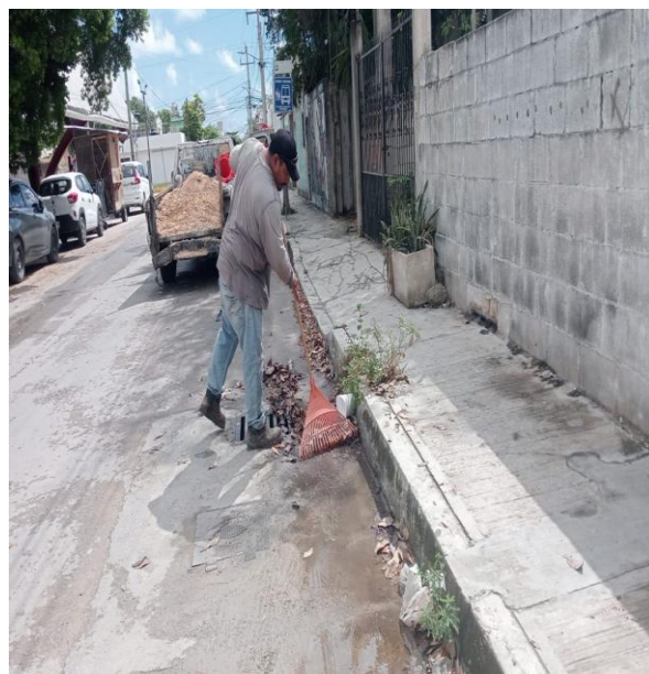
Limpieza de rejillas. Calle gama oriente entre calle centauro sur y av. satélite; colonia centro.
